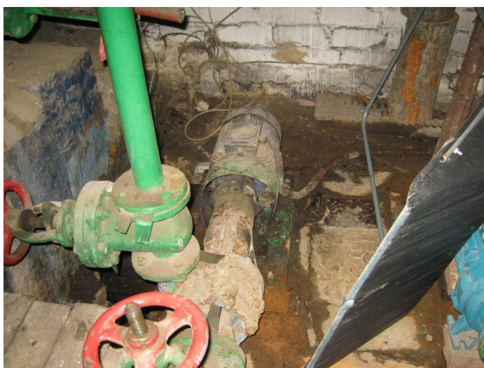
Рисунок 1.2.21.- 1.2.23. Котельная ООО «Сокол»
