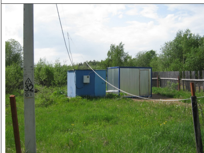
Рисунок 6.4.10 – Павильон скважины №3639 по ул. Мичурина, п. Антропово
