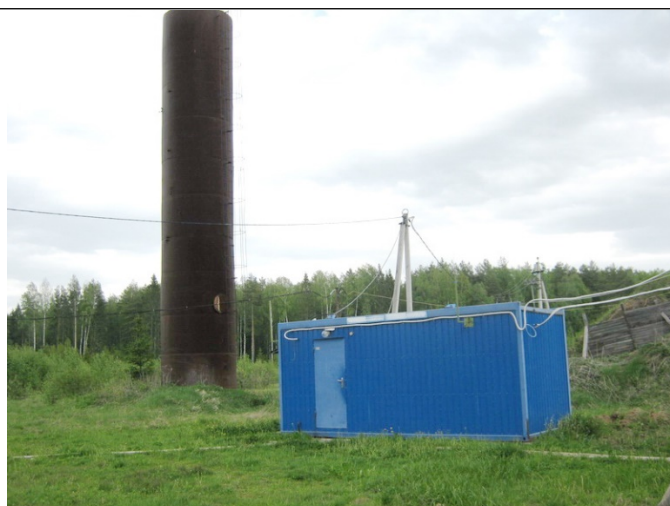
Рисунок 6.4.13 – Станция водоочистки и РЧВ на водозаборе Сосновка п. Антропово
