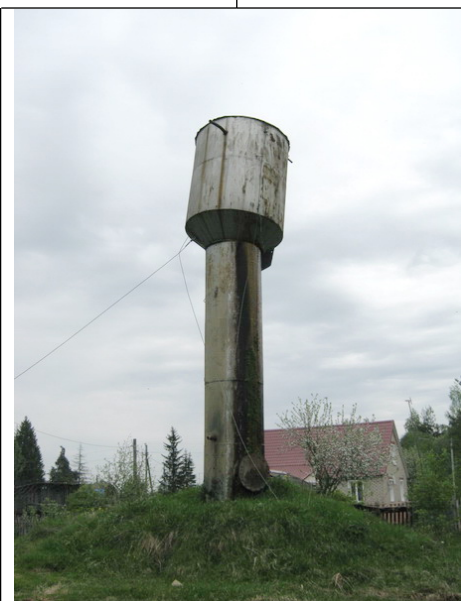
Рисунок 6.4.6 – ВНБ п. Антропово, ул. Энергетиков
